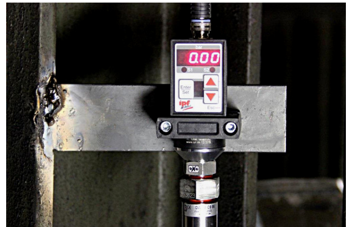
Abbildung 4: Der Drucksensor verfügt über einen Messbereich von -1 bis +10bar. Das analoge Ausgangssignal des Gerätes wird dazu genutzt, die Geschwindigkeit des Ventilators sowie die Klappenpositionen im Rohrsystem zu regeln.
